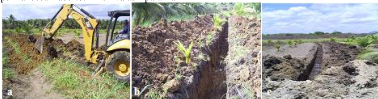
Figura 2 - Reabertura do dreno coletor (a e b) e vista de uma das valas para a instalação dos drenos laterais (c).
