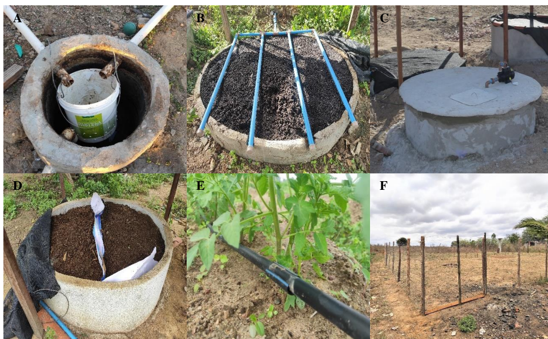
Figura 1. Caixa de gordura (A), filtro biológico (B), tanque de reuso (C), minhocário (D), Sistema de irrigação tipo xique-xique (E) e quintal cercado (F).
